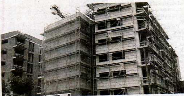
Construcció d'habitatges a Sabadell. L'autor aposta per no tornar a hipoteques superiors al 100% i per la rehabilitació i l'habitatge protegit. / EMILI BELLA
